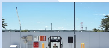
【燃料確保(インタンク)】
