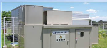
【非常用自家発電設備】
