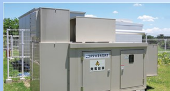
【 非常用自家発電設備 】
