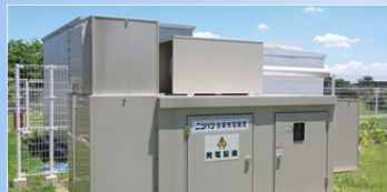
【非常用自家発電設備】
